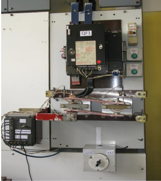
Figure 2 Рисунок 2. Вводной автомат QF1 с системой управления
