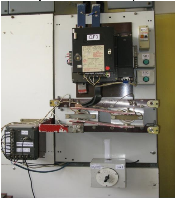
Figure 2 Рисунок 2. Вводной автомат QF1 с системой управления
